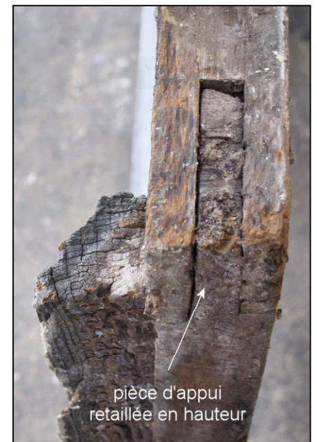
Fig. 11.7. Pièce d'appui pièce d'appui retailée en hauteur
